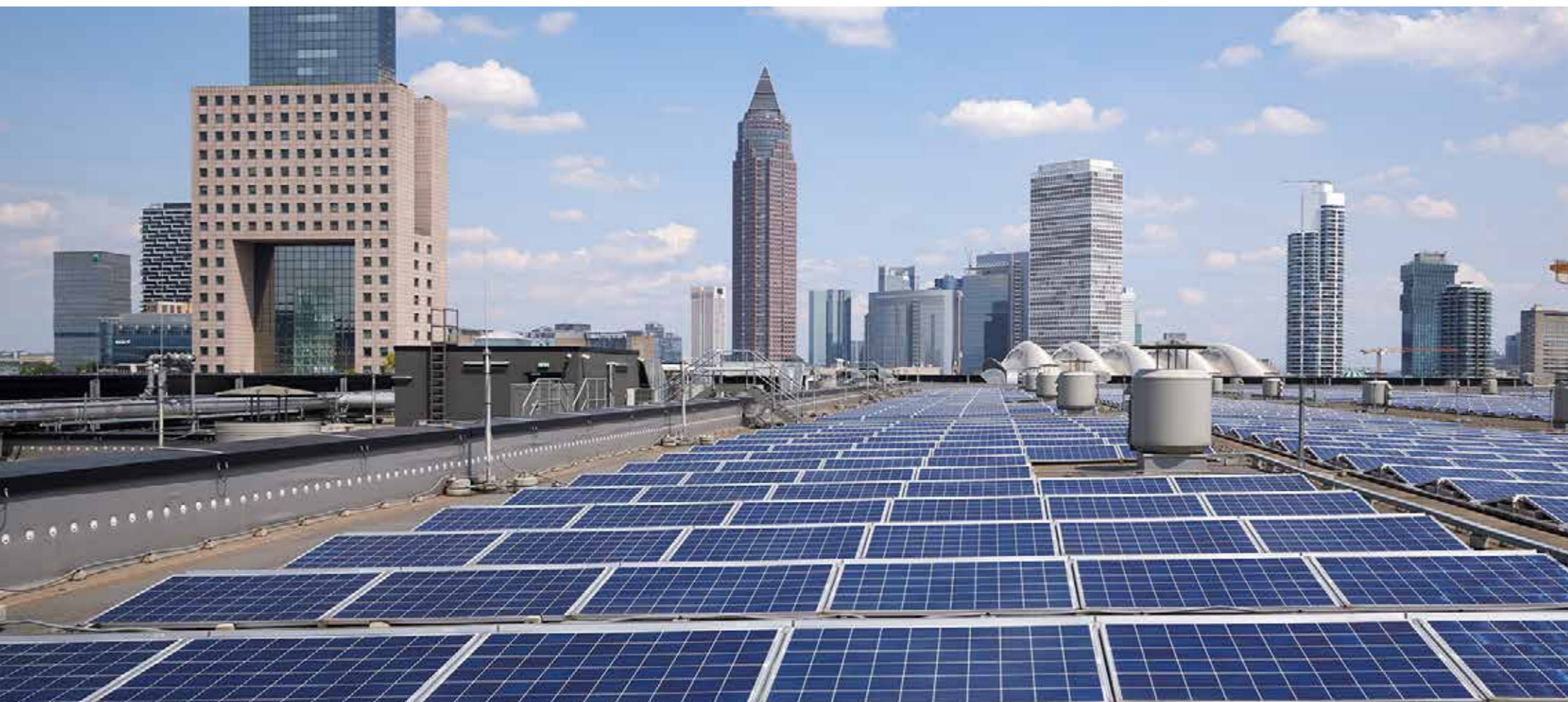
Dass ein nachhaltigerer Umgang mit den natürlichen Ressourcen auch für die Messe Frankfurt selbst längst eine tragende Rolle spielt, zeigt ein Blick auf das Dach der neuen Halle 12. ▲
